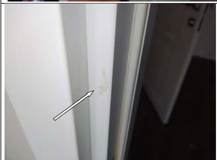
Фото №30. Коробка деревянного дверного блока в спальне имеет дефекты (загрязнение строительными составами).
