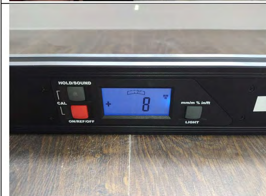
Фото №11. Измерение уровня напольного покрытия в спальне.
