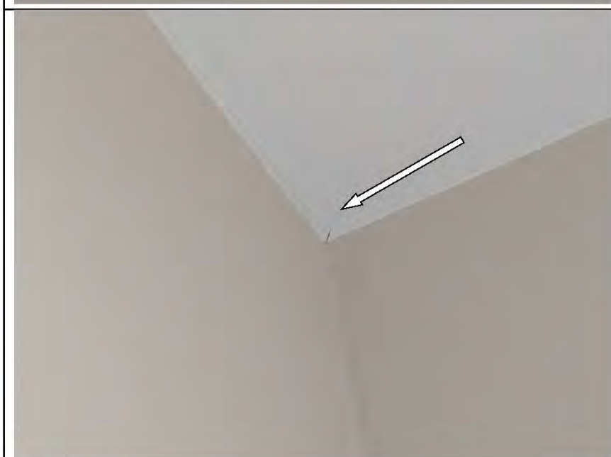
Фото №50. Дефект монтажа декоративного молдинга натяжного потолка в ванной комнате.
