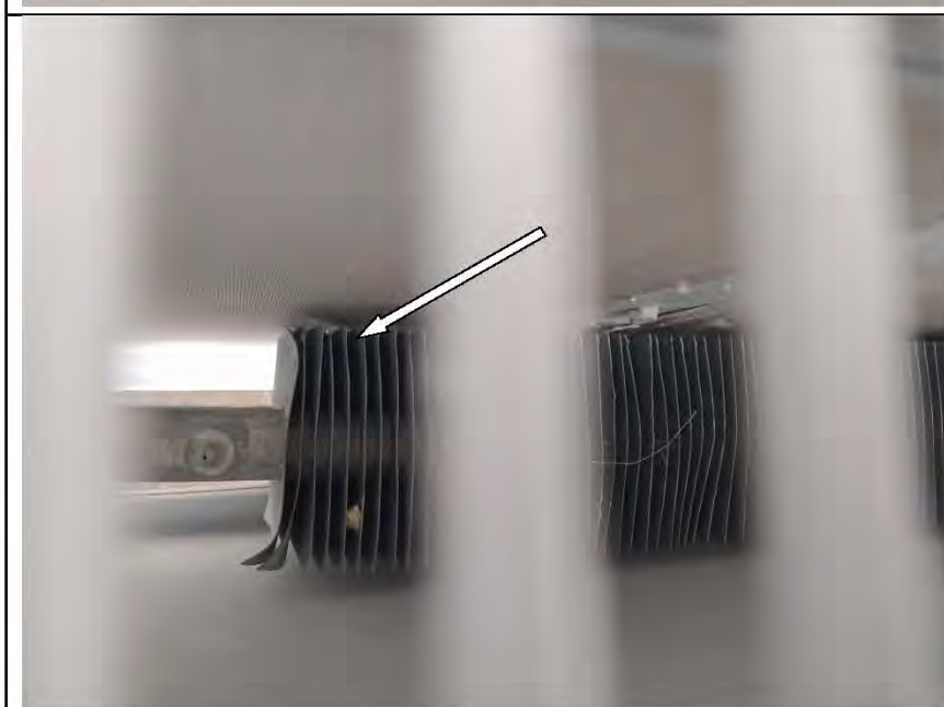
Фото №51. Радиатор в спальне имеет дефекты (замятия).
