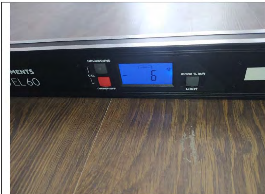
Фото №13. Измерение уровня напольного покрытия в кухне.
