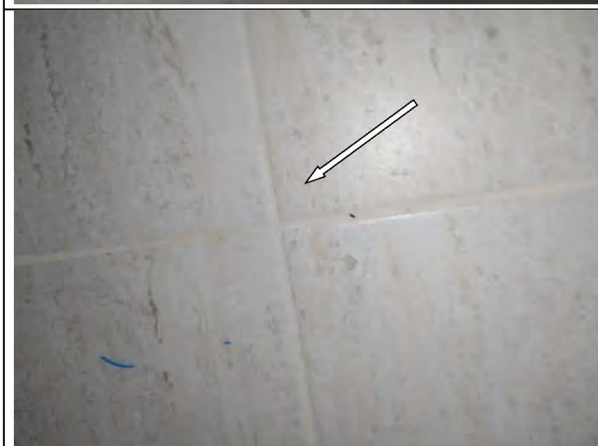
Фото №39. Затирка напольной плитки выполнена с нарушениями в ванной комнате: разность ширины шва.
