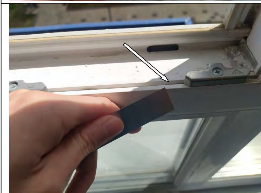
Фото №23. Профиль ПВХ оконного блока в спальне имеет дефекты (скол).
