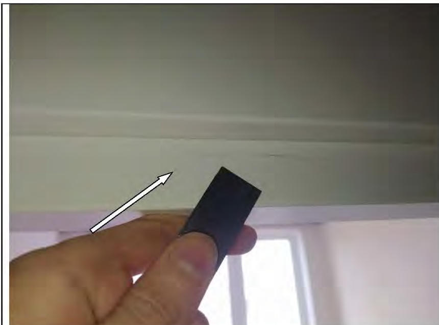
Фото №31. Коробка деревянного дверного блока в спальне имеет дефекты (царапина).
