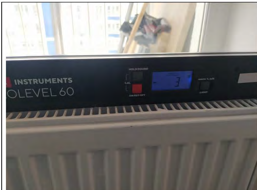
Фото №52. Отопительный прибор смонтирован неровно в кухне
