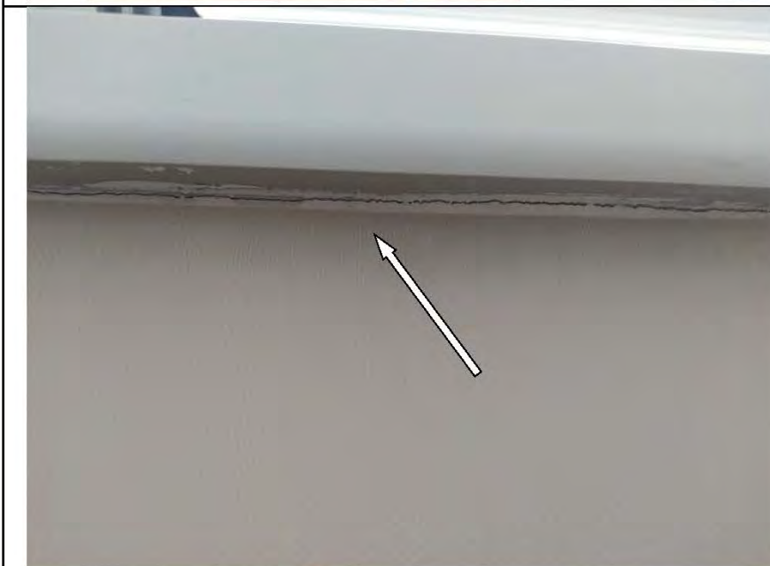
Фото №26. Отверстие под подоконником в спальне не загерметизировано.
