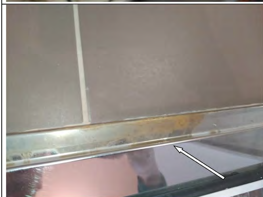
Фото №54. Коробка входной металлической двери имеет дефекты (коррозия).
