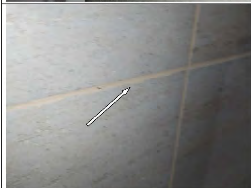
Фото №38. Затирка настенной плитки в ванной комнате выполнена с нарушениями (каверны).
