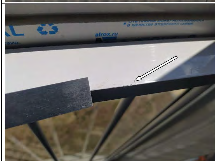
Фото №53. Дефект на металлическом профиле оконного блока на лоджии (скол).
