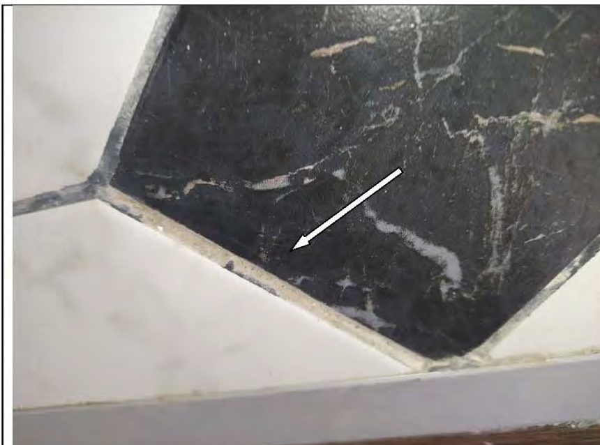
Фото №40. Затирка напольной плитки выполнена с нарушениями в кухне: неполное заполнение шовного пространства.
