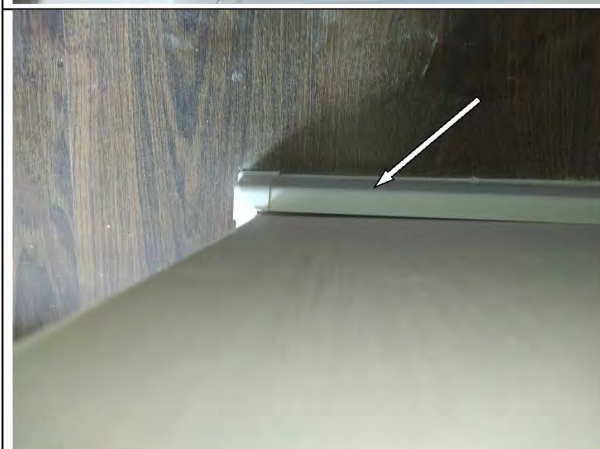
Фото №44. Напольный плинтус ПВХ неплотно прилегает к стене (отходит), образуется зазор в кухне.
