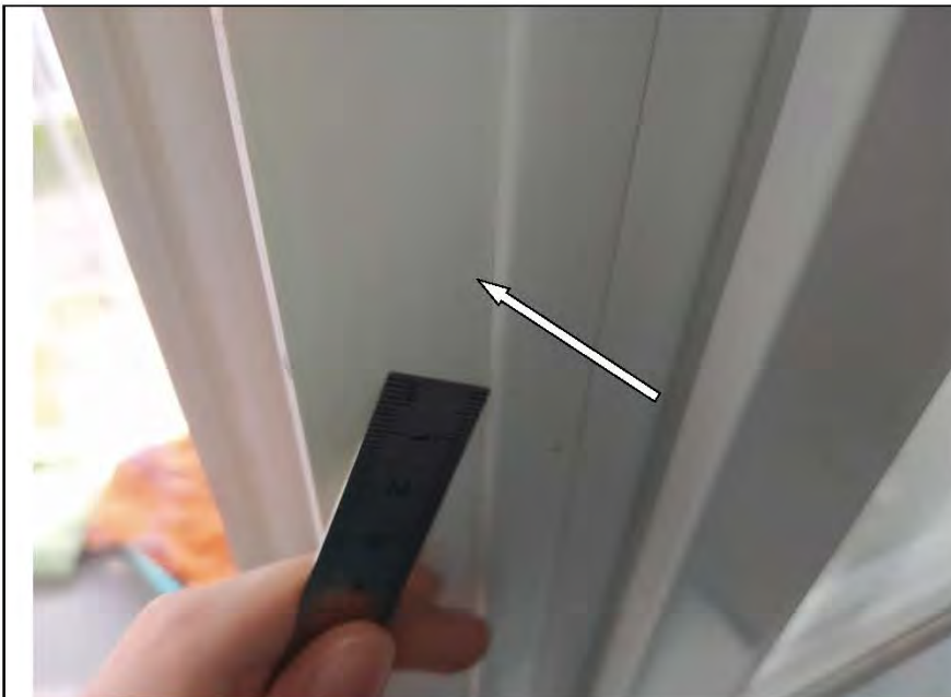
Фото №22. Профиль ПВХ оконно- дверного блока в кухне имеет дефекты (царапины).
