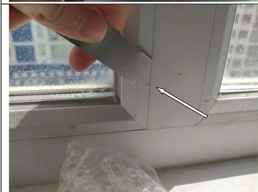
Фото №24. Профиль ПВХ оконного блока в спальне имеет дефекты (скол).
