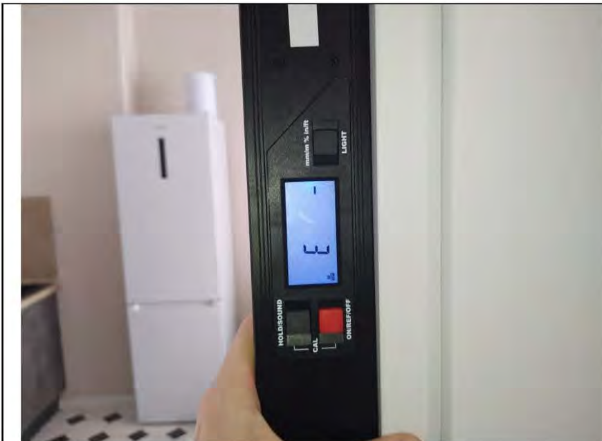
Фото №28. Отклонение коробки дверного блока в кухне.
