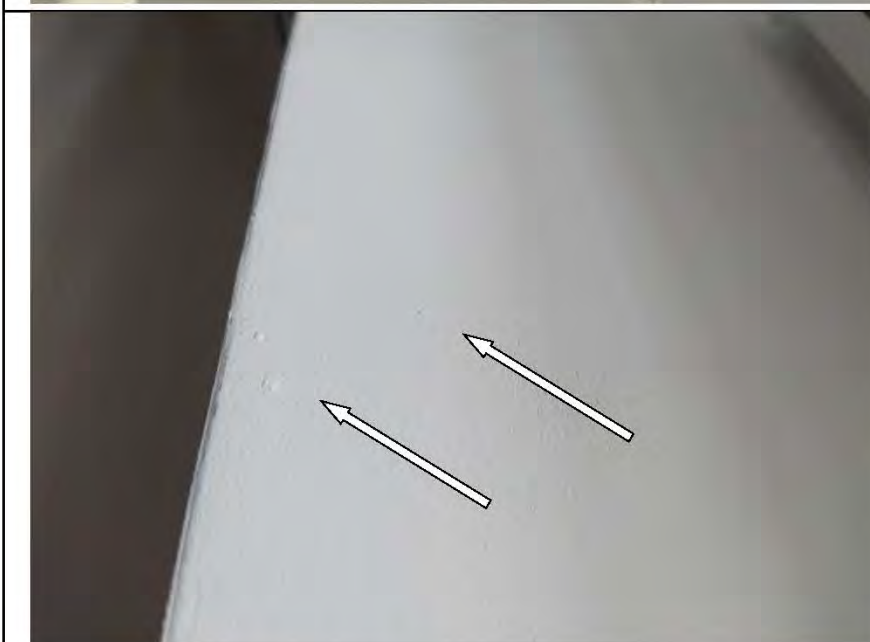
Фото №17. Окрашенные откосы оконно-дверного блока ПВХ в кухне выполнены с дефектами (брызги).
