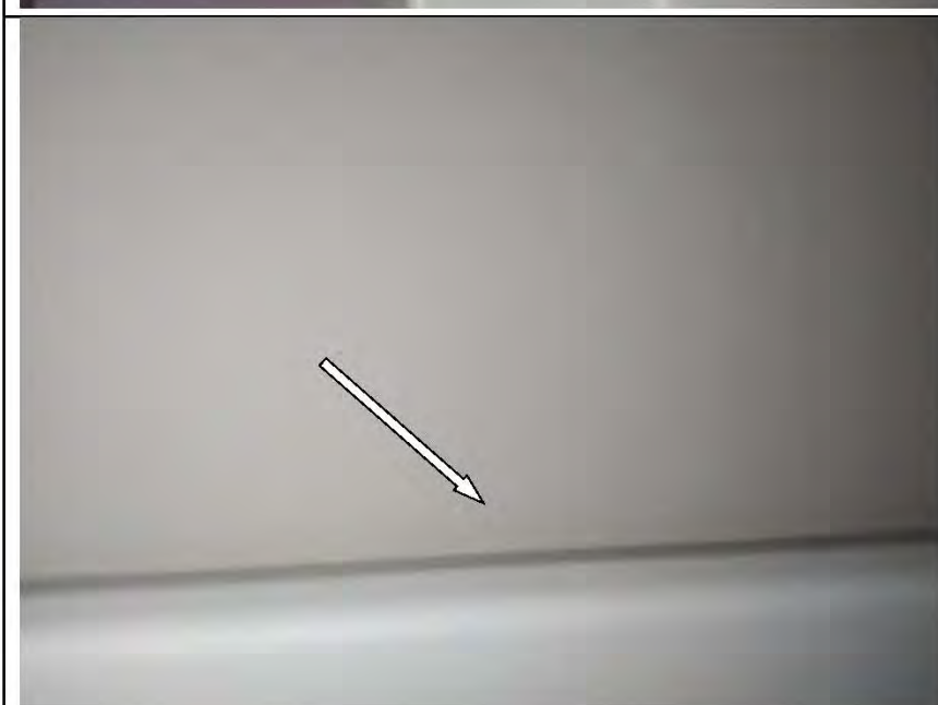
Фото №35. Неплотное прилегание дверного наличника к стене в ванной комнате.
