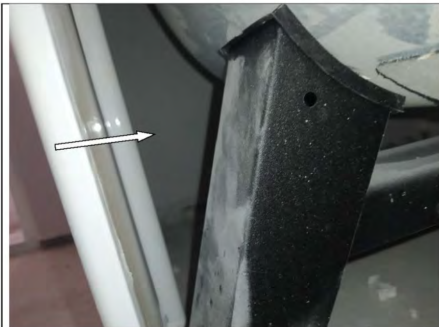
Фото №55. Частично отсутствует настенная керамическая плитка за ванной.
